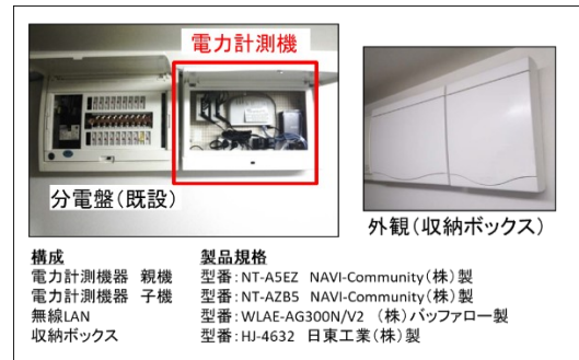
図 4-21 各住戸に設置した電力計測器
