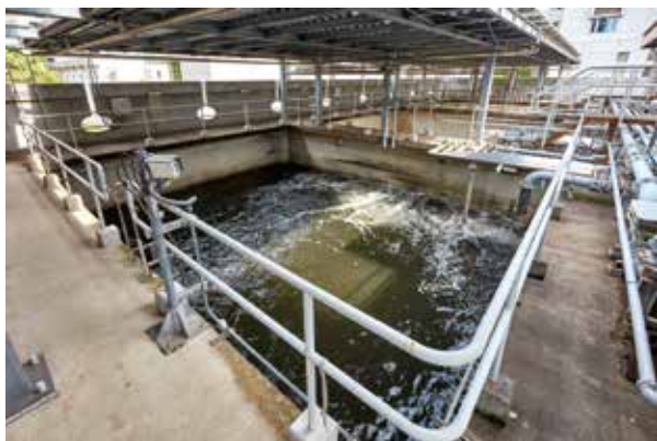
実験廃水処理施設（貯留槽：500 t × 3槽）
