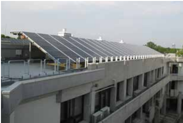
太陽光発電設備（研究本館屋上）
