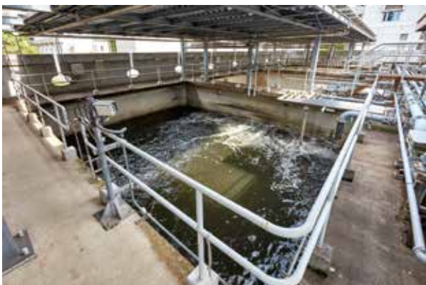
実験廃水処理施設（貯留槽：500 t × 3 槽）
