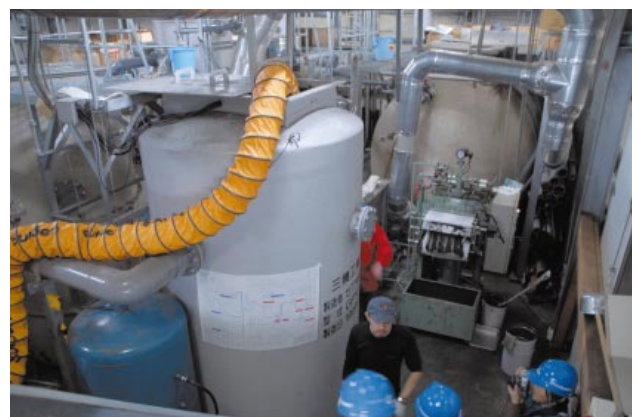
写真3 汚水処理棟の内部
