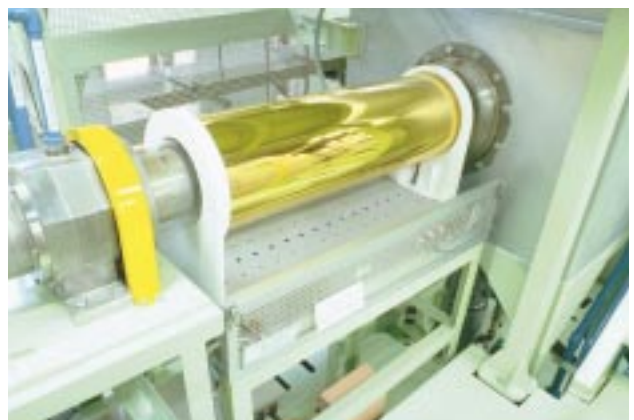
写真4 熱処理プラント（一次燃焼室）
