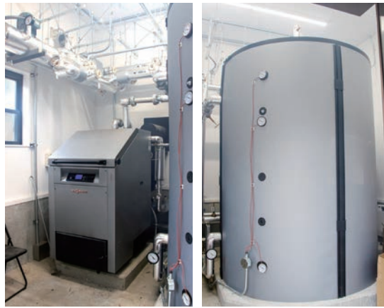
森林をエネルギー活用の切り口として活用した事例である、生活工芸館の薪ボイラー冷暖房システム（左）薪ボイラー（右）貯熱タンク
