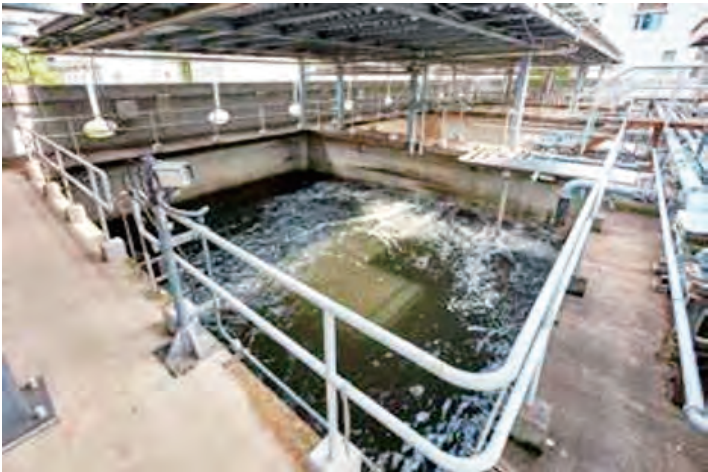
実験廃水処理施設(貯留槽：500 t × 3 槽)
