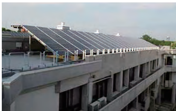
太陽光発電設備(研究本館屋上)
