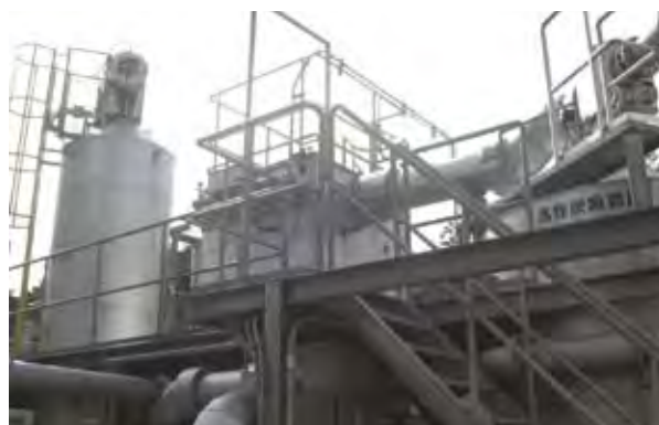
特殊固体焼却設備用排ガス処理装置
