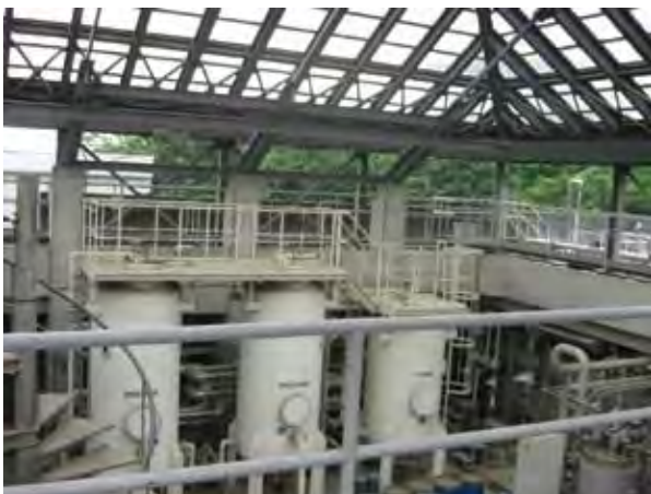
一般実験廃水処理施設
