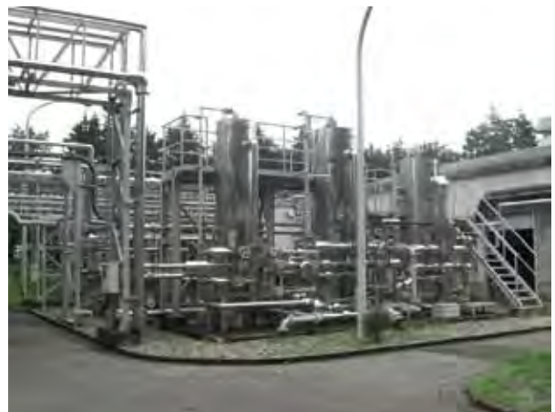
特殊実験廃水処理施設
