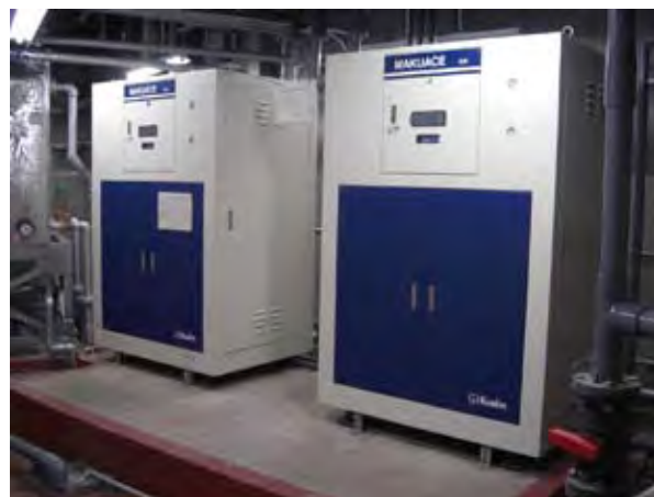
一般実験廃水処理施設再利用水処理施設
