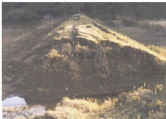
図2．地震によるため池の決壊事例.
